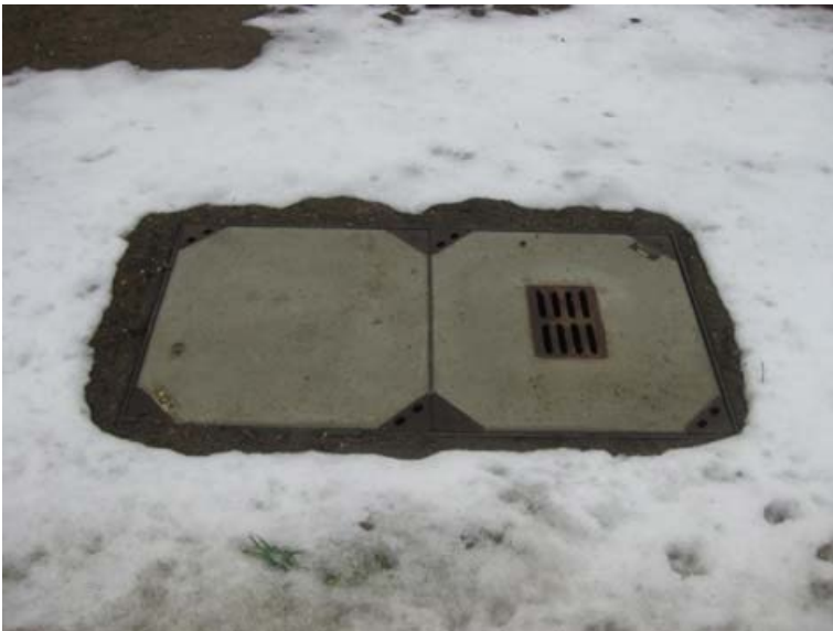
Abbildung 5: Crossbondingschacht, Beispiel (Quelle: Amprion)
