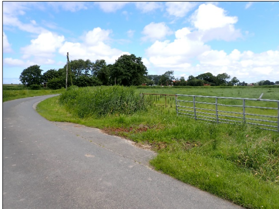
Abb. 6: Graben am Pannoger Weg, E.Nr. 701
